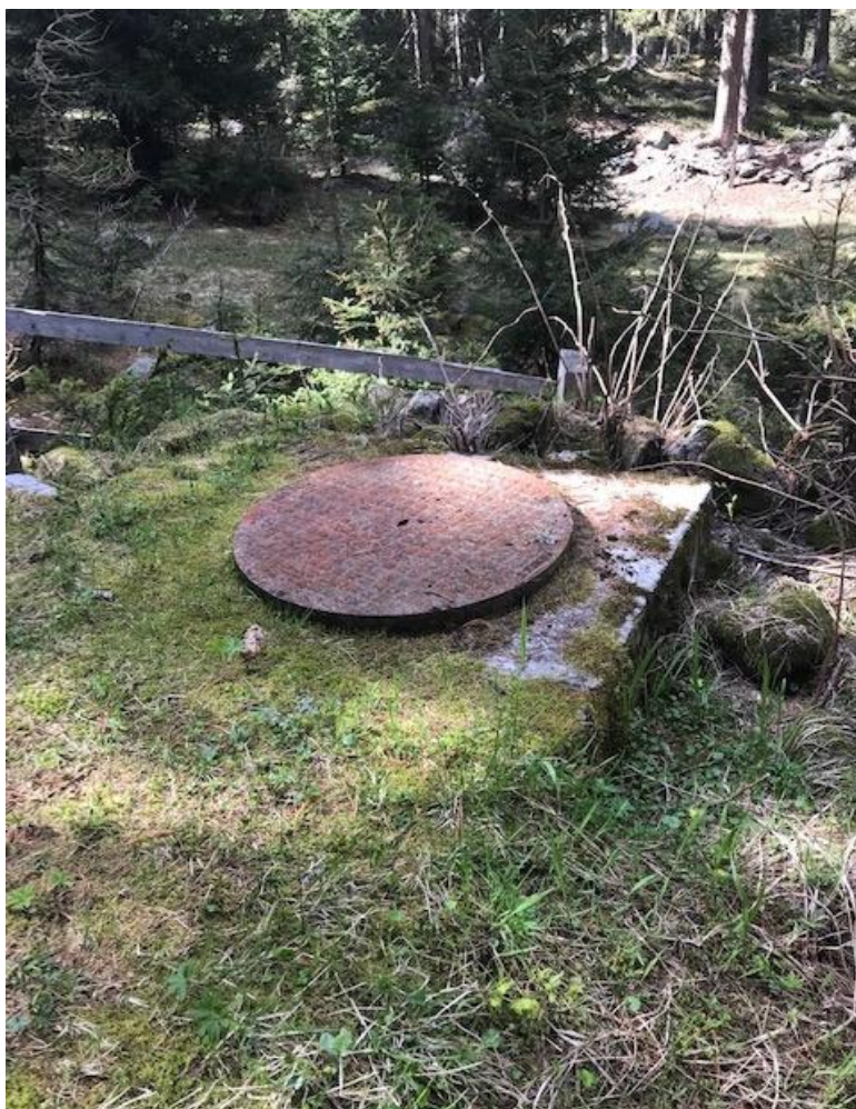
Infrastruktur der Wasserversorgung, die in die Jahre gekommen ist, muss ersetzt werden (Foto: Marcus Cola, Brunnenmeister)
