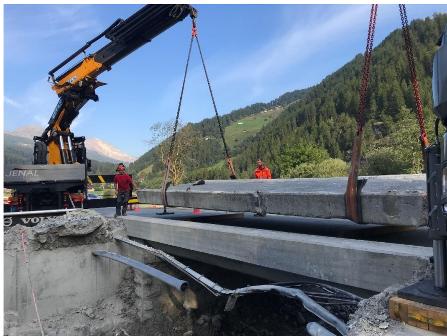
Die Fussgängerbrücke in Bos-chetta, beschädigt durch die Rufe vom 22.08.2021 (Foto: Forstamt VM, Florian Flehsig, Förster)
