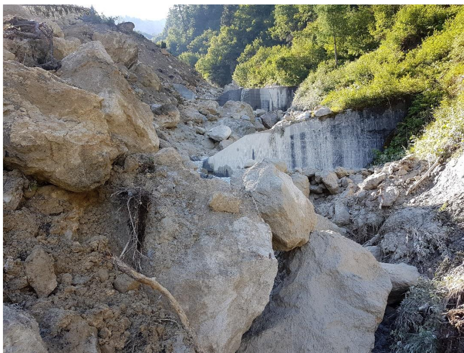
Rüfenverbauung Val Schais, gefüllt mit Material, das in Bewegung ist.
